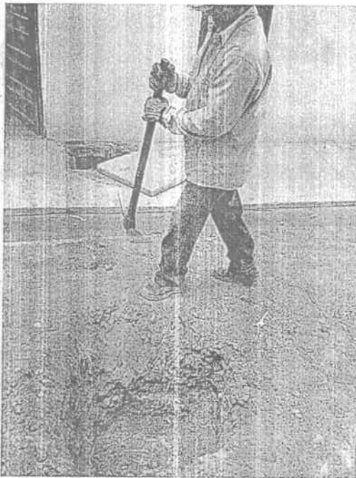
Fotografía No. 1 Poza séptica enterrada a unos 0,5 metros bajo tierra. Se manifiesta que actualmente los residuos contenidos en la poza se disponen con gestor especializado.
